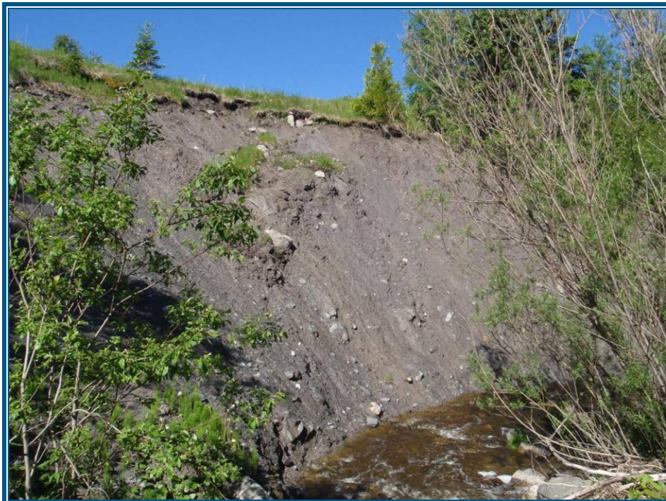
Photo 26 : Décrochage le long du cours d'eau Brand en aval de la route 132
